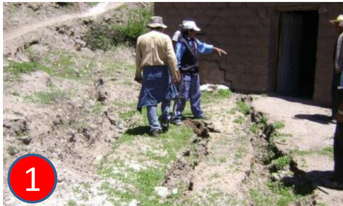
1 Viviendas afectada por el deslizamiento. Poblado de Amata. 2011
